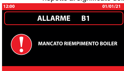
Esempio finestra di allarme.
